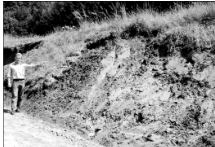
Im Juli 2005 gab es ein Unwetter, das viele Wegbereiche abschwemmte (im Bild ein Schadensfall im Eselsteiggraben). Die Schadenssummen belaufen sich auf 15.500 EUR. Die Wiederinstandsetzung erfolgte durch die Firma Rauner und wurde von der Gemeinde vorfinanziert.
