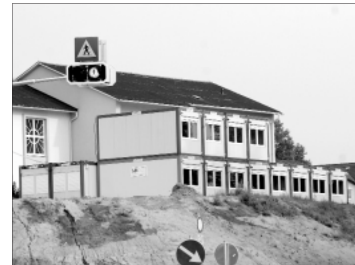
Der Schulbetrieb kann trotz der Umbauarbeiten mit der Containerlösung reibungslos weiter geführt werden.
